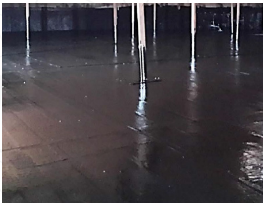
▲ مخزن ذخیره نفت پس از اجرای پوشش کامپوزیتی
